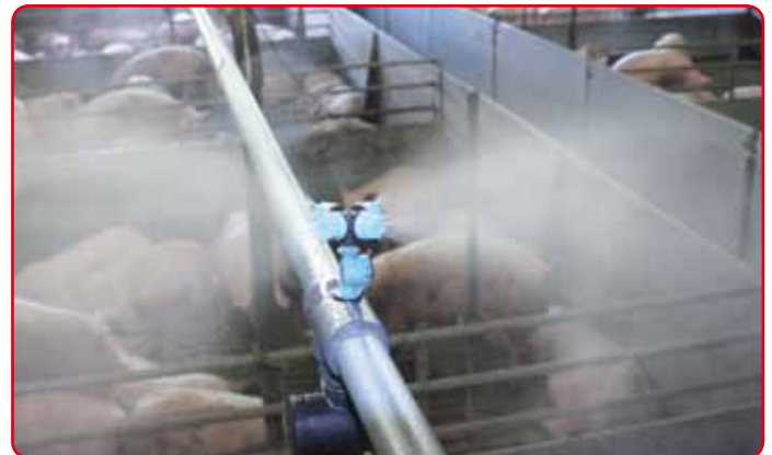
Kühlung im Maststall.
